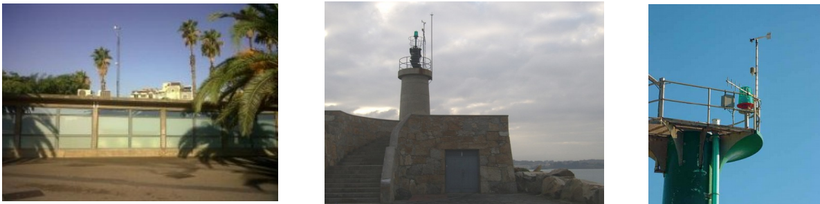
Fig. 1. Instalación de algunas estaciones meteorológicas REMPOR
